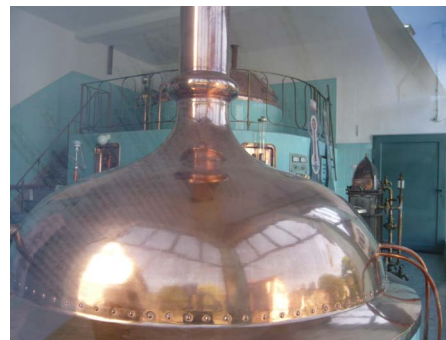
Kessel im Inneren
